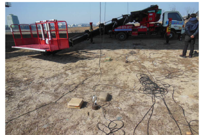
(처짐계 설치 현황)
