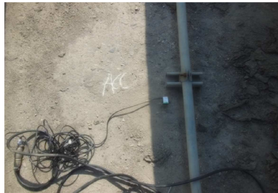
(가속도계 설치 현황)
