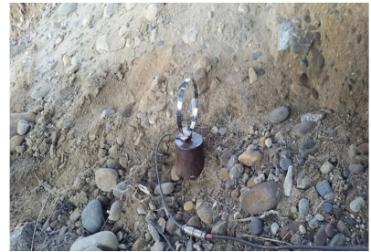
(처짐계 설치 현황)
